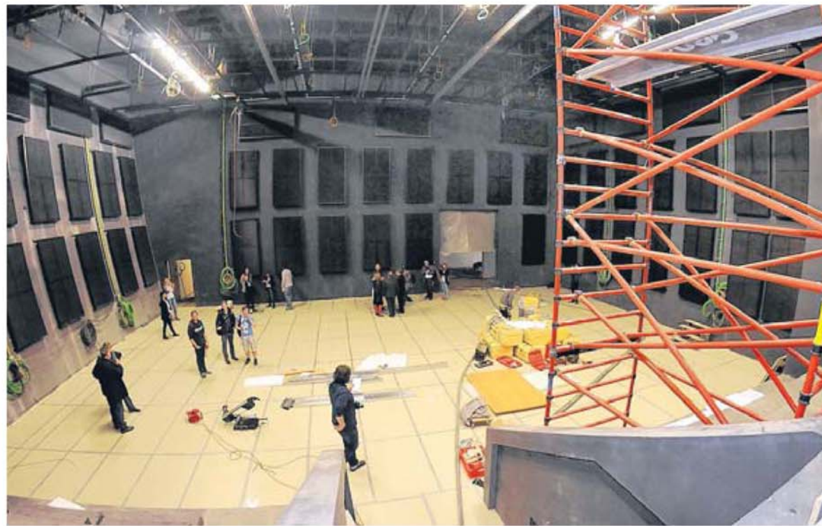
Das 400 Quadratmeter große Fernsehstudio mit seinen 200 Zuschauerplätzen wird einmal das Herzstück des neuen Mittweidaer Medienzentrums sein. Sogenannte Absorberelemente an den Wänden, die der Schalldämmung dienen, und der Fußboden sind bereits eingebaut.
